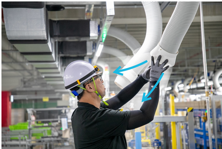
Coupang 酷澎設置HVAC空調系統，物流員工可自行調整涼風吹送位置，實現個人化空調的目標。 (示意圖)
