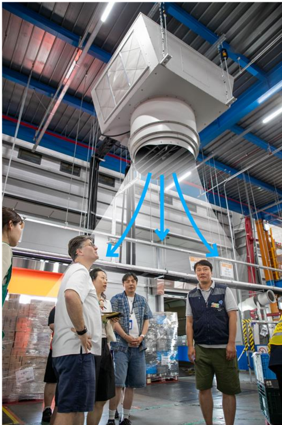
2025年7月11日□CFS代表董事Ryan Brown在昌原3中心視察HVAC設備。
