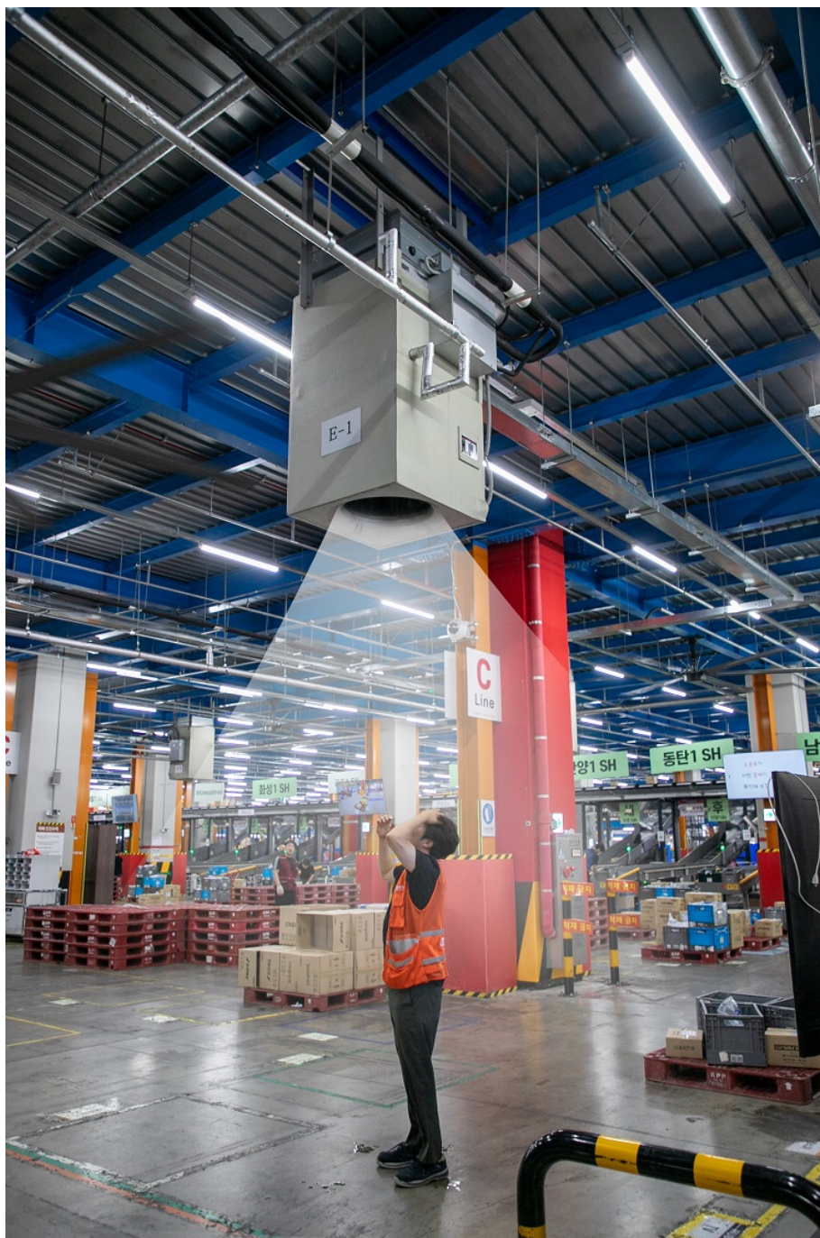
仁川14中心一名員工在冷氣設備下消暑。中心內HUB工程區域設有大型空間散熱器「Unit Cooler」和大型吊扇「HVLS, High Volume Low Speed」由天花板式系統空調的大型空間散熱器吹出冷風，大型吊扇產生氣流，帶來冷氣循環。
