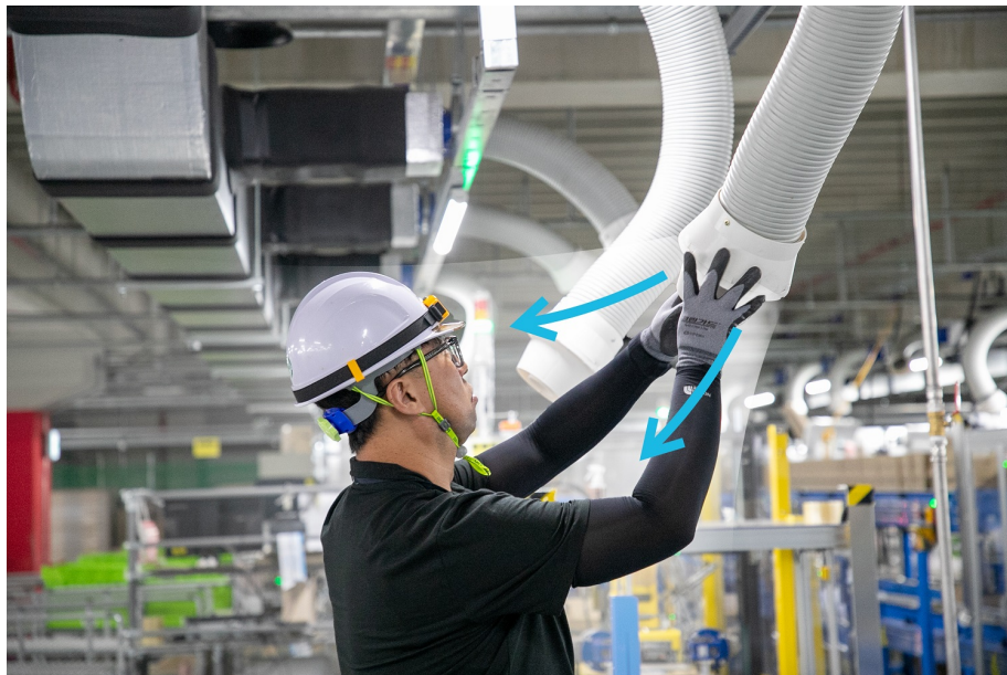
工程安全團隊的 Linus 正在仁川14中心檢查已完工的冷氣空調設施運轉狀態。
