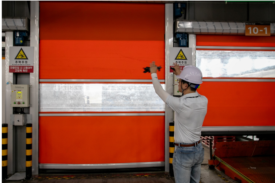
工程安全團隊的 Daniel 正在說明仁川14中心的冷氣隔門「Speed Door」冷氣隔門設在與外部連結的碼頭區，最大限度地減少冷氣外流，提高冷氣效率。
